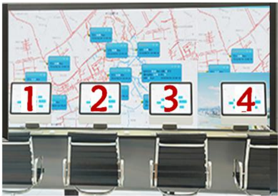
图12 水司调度中心实时监控多个水厂
